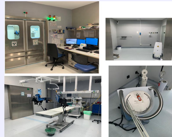
Sala de tratamiento de RT y unidad móvil (carga diferida remota).
